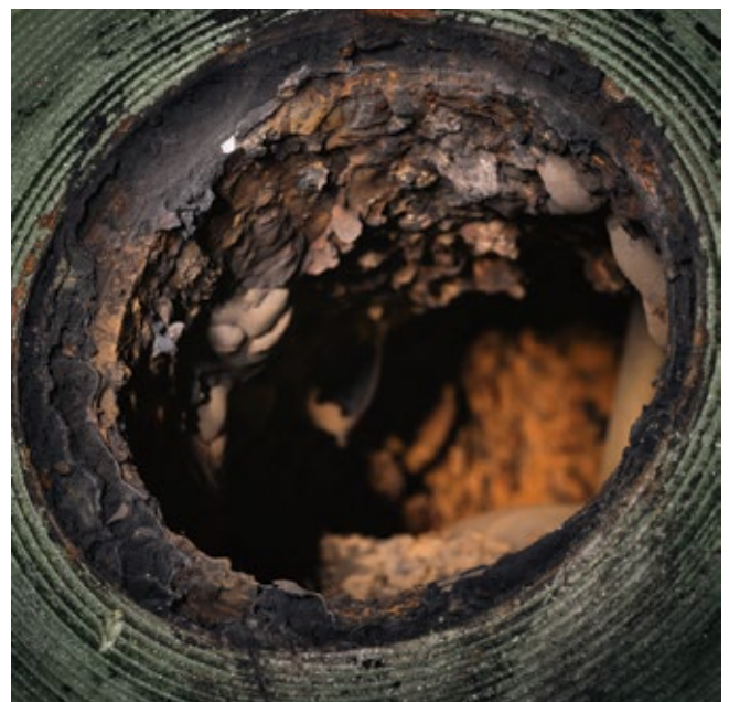
Afb.2: Vervuiling in een pomp
